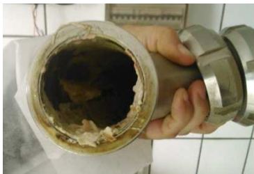
Encrassement et défaut de circulation
